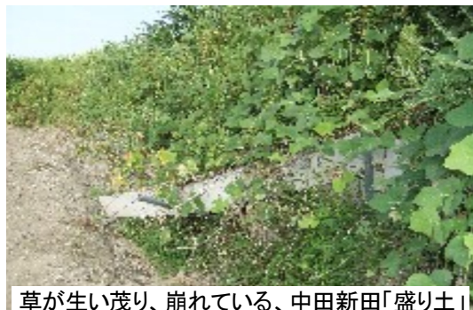
草が生い茂り、崩れている、中田新田「盛り土」
